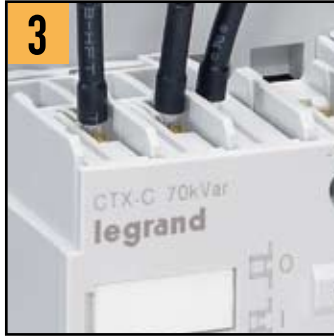
Kablolaması yapılmış deşarj dirençleri
